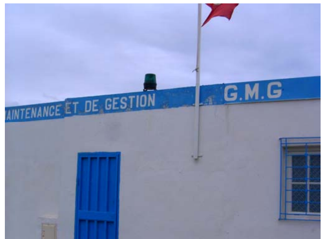
Gyrophare installé sur le toit du siège GMG Sousse
